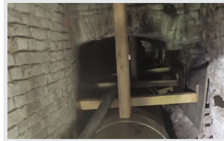
GFK-Rohrstrang mit Auftriebssicherung
