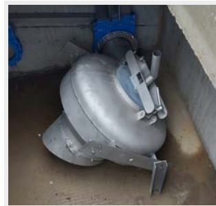
Wirbelventil im Entlastungsbauwerk
